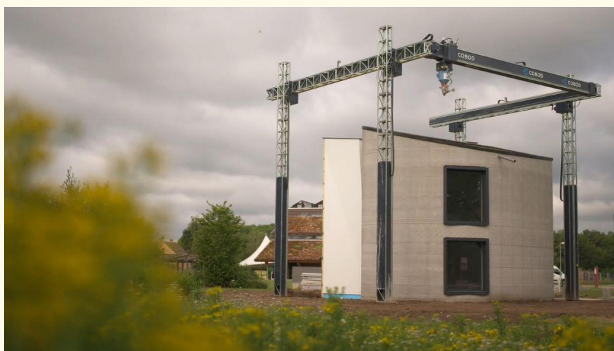
Σχήμα 4: Το πρώτο τρισδιάστατα εκτυπωμένο διώροφο σπίτι της Ευρώπης στο Βέλγιο, μαζί με τον εκτυπωτή BOD2 που το δημιούργησε.
